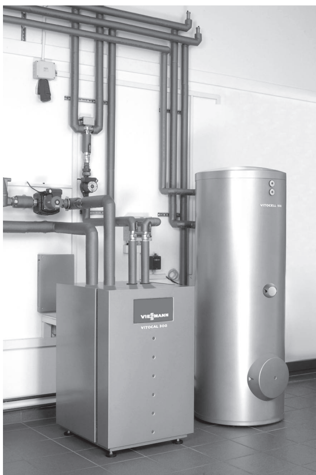
Rys. 2.6. „Kotłownia” z pompą ciepła Vitocal 300
