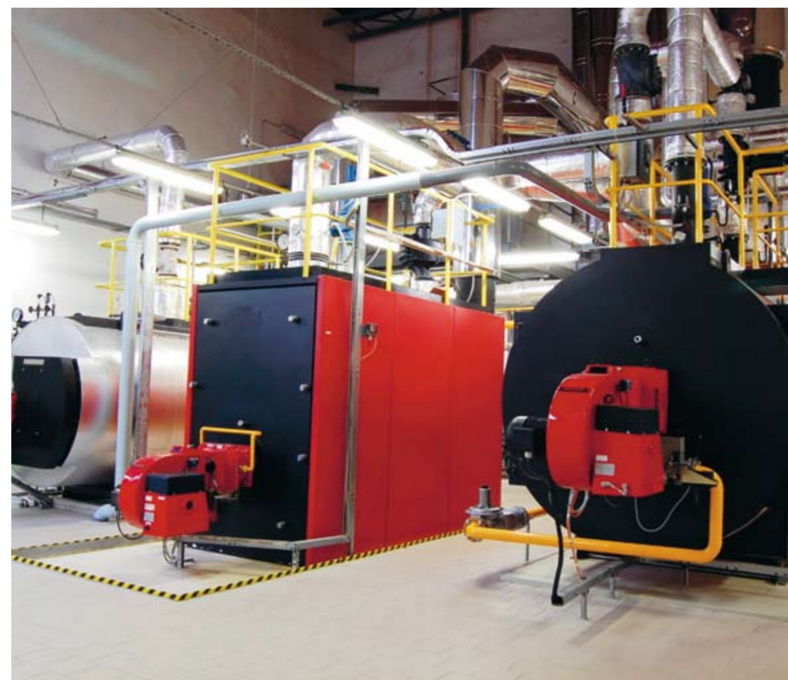
Systemy HVAC odpowiadają za 50% zużycia energii w budynku
