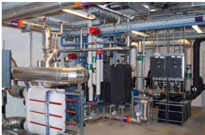
Pięć płytowych wymienników ciepła Alfa Laval zainstalowanych w układzie instalacji lodowiska Malmö Ice Stadium.
