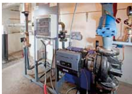
Wewnętrzna sieć jest podłączona do zewnętrznej pętli poprzez węzeł Maxi.
