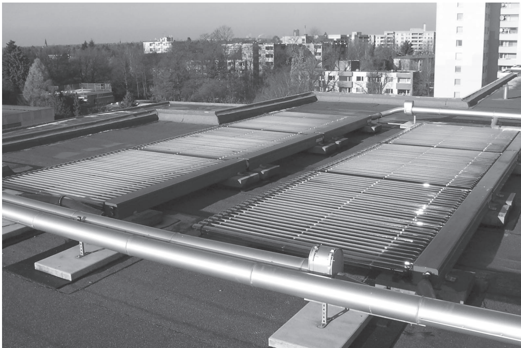
Rys. 3.3. Instalacja kolektorów słonecznych Vitosol 200 zainstalowanych na dachu budynku wysokiego.
