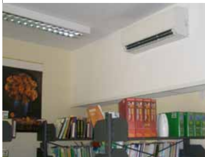
Jednostki wewnętrzne systemu FUJITSU MULTI 8 w pomieszczeniu głównym czytelni...
