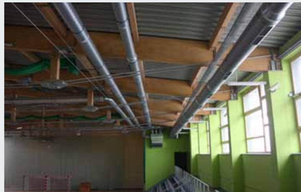
Wnętrze, system wentylacyjny, hala sportowa Słomniki
