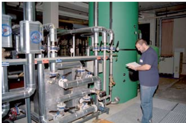
Kierownik ds. Urządzeń Sanitarnych, Christian Frank, regularnie kontroluje temperatury ciepłej wody i zmiany ciśnienia w płytowych wymiennikach ciepła.
